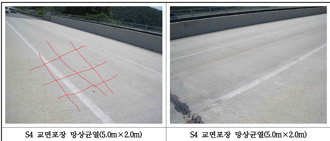
【사진 3.20】 교면포장 손상현황
