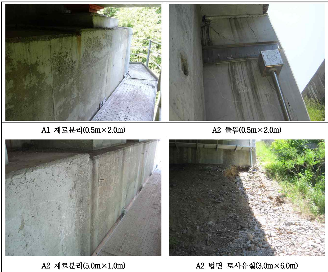
【사진 3.9】교대 손상현황
