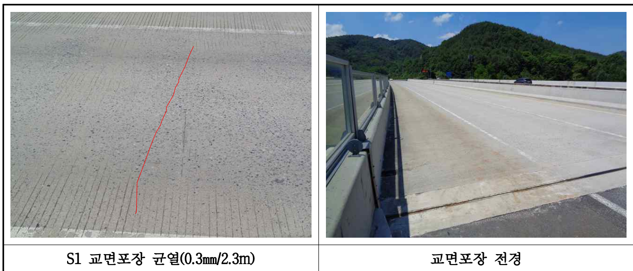
【사진 3.45】 교면포장 손상현황
