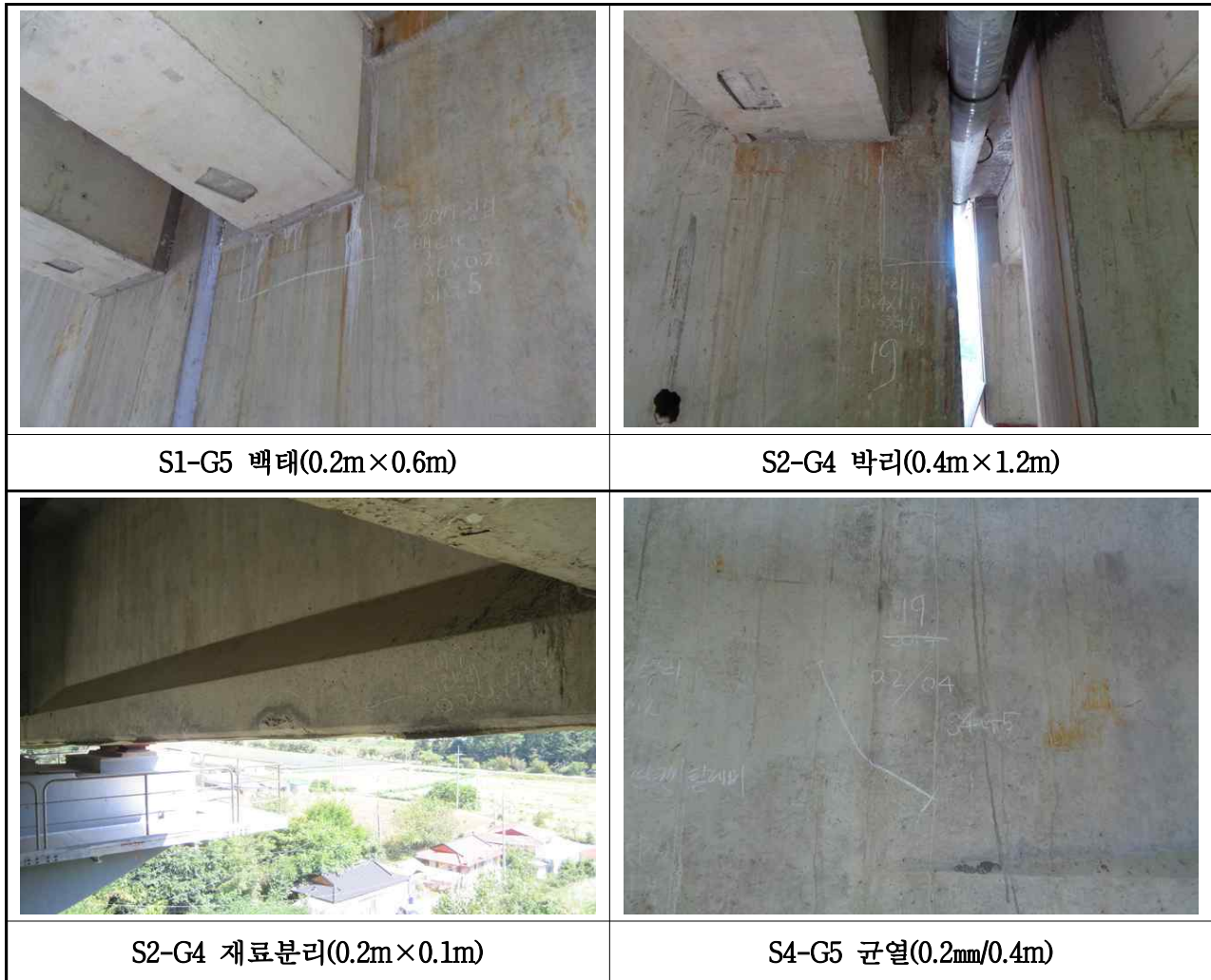
【사진 3.30】거더 손상현황
