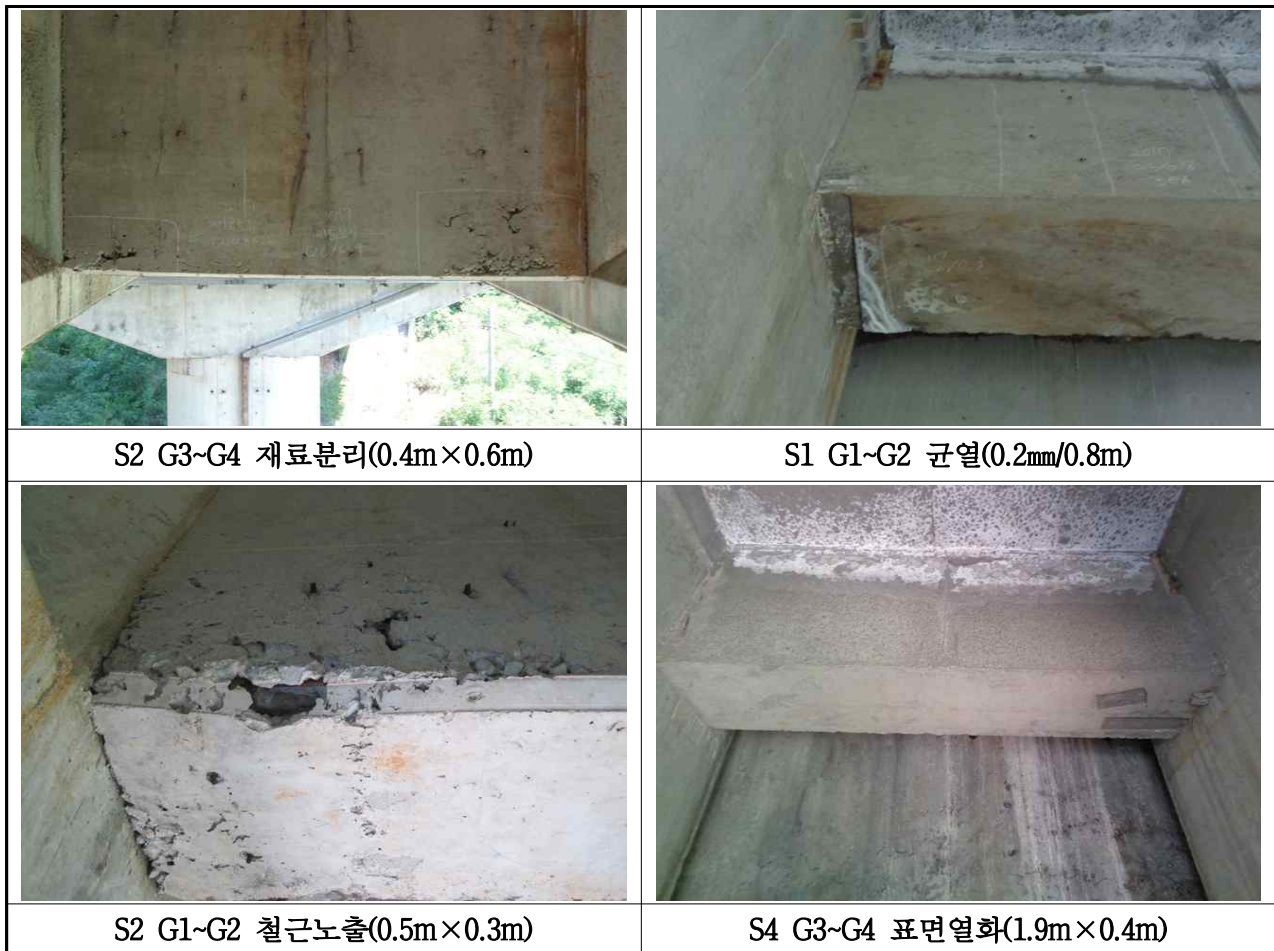
【사진 3.32】 가로보 손상현황
