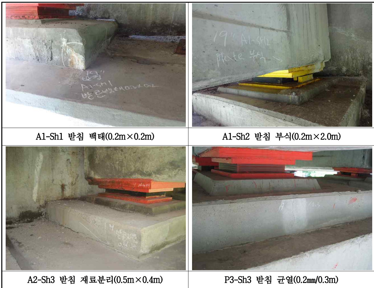
【사진 3.13】 교량받침 손상현황
