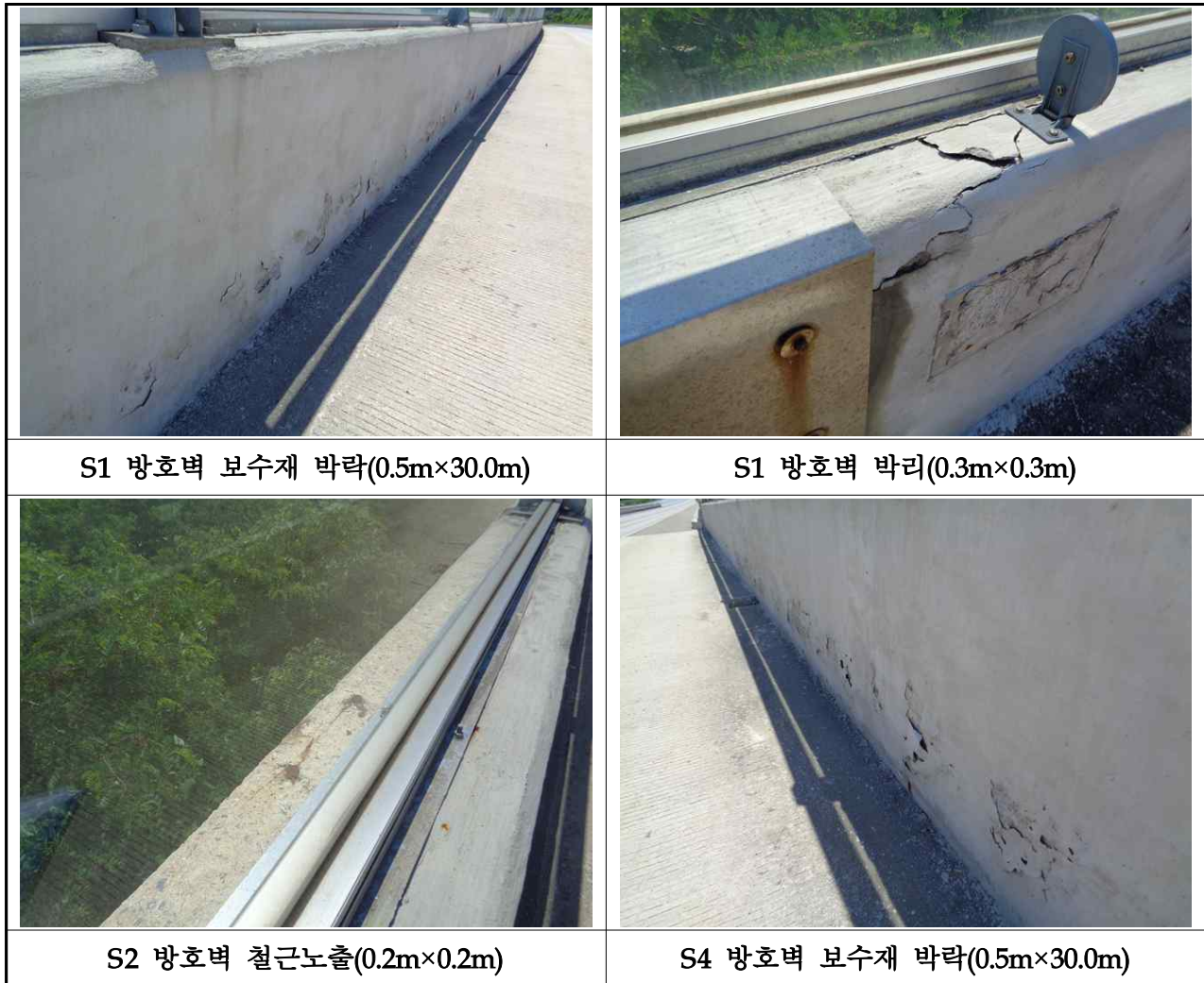
【사진 3.49】 방호벽 및 중앙분리대 손상현황
