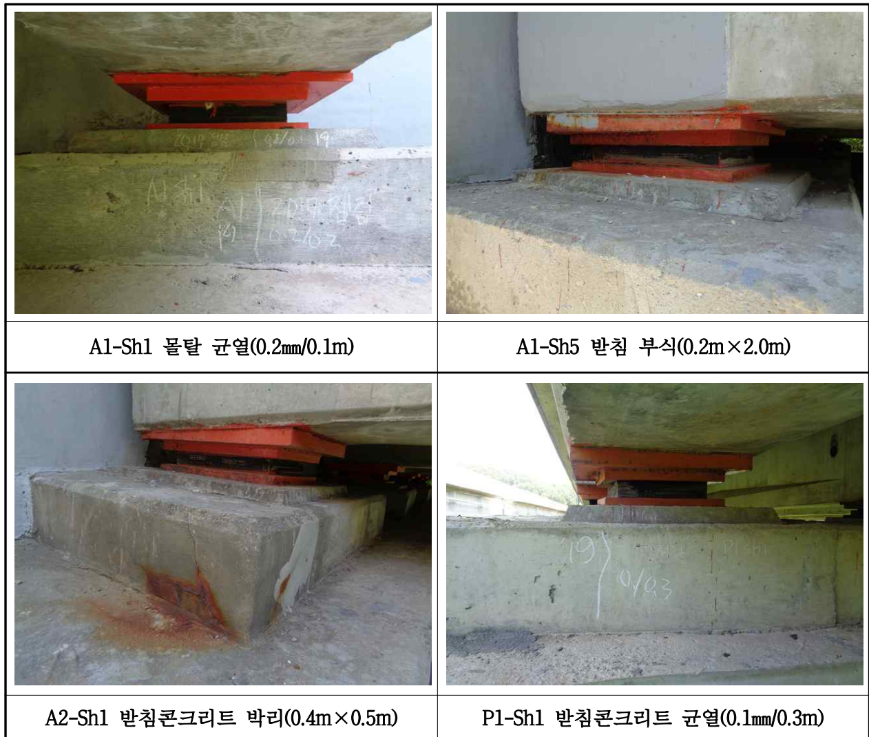
【사진 3.38】 교량받침 손상현황
