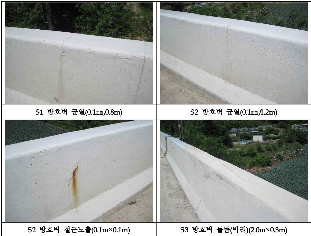
【사진 3.24】 방호벽 및 중앙분리대 손상현황
