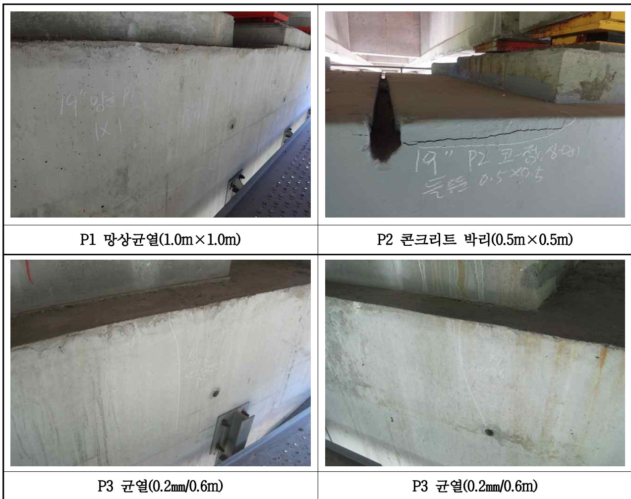
【사진 3.11】 교각 손상현황
