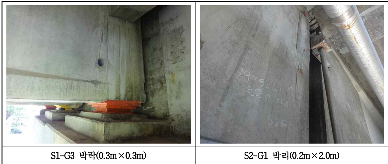
【사진 3.5】 거더 손상현황
