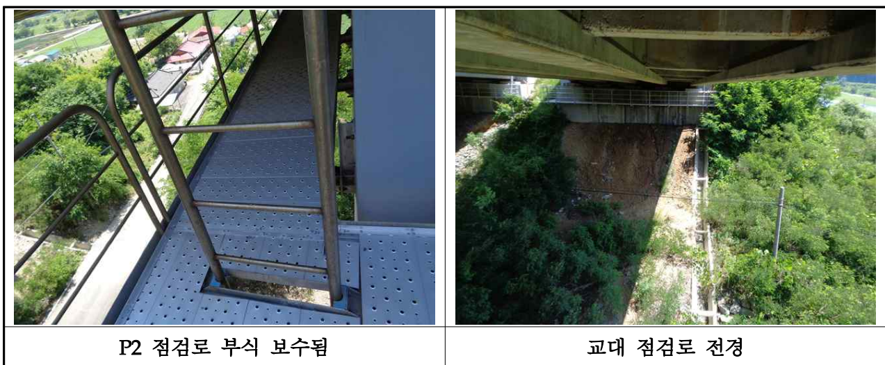
【사진 3.51】 교량 점검시설 손상현황
