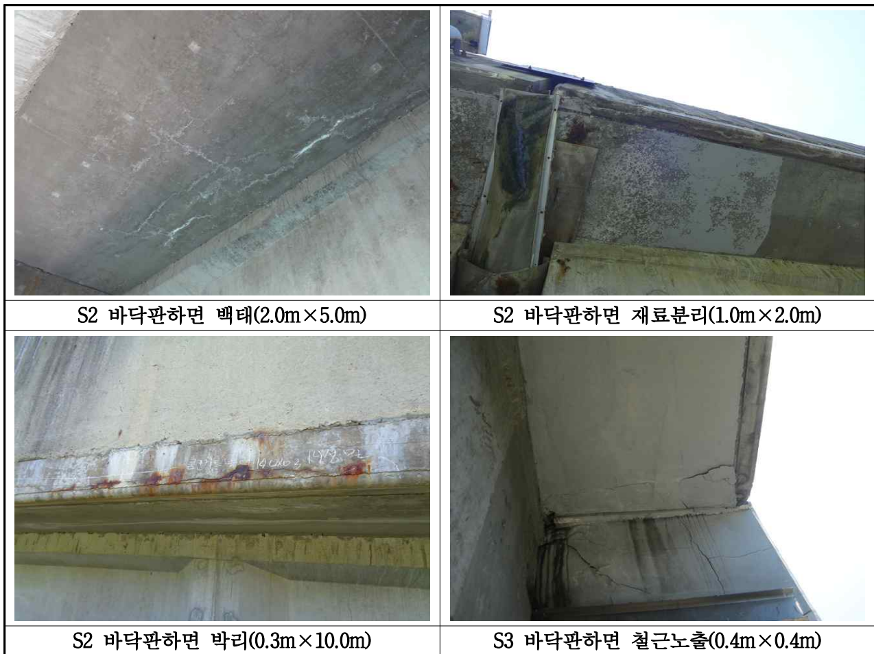
【사진 3.3】 바닥판하면 손상현황
